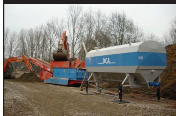
Silo 15 à 45 tonnes avec dosage
